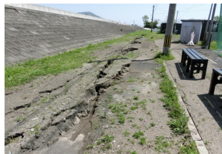
堤体の液状化
