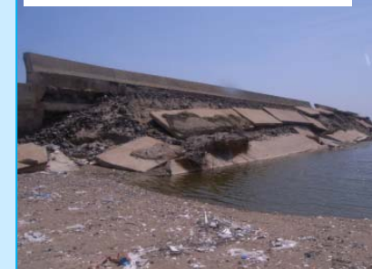
津波により洗掘された堤防
