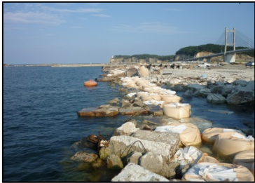
地震により岸壁が倒壊
