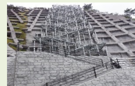
防災安全施設 (土砂崩壊防止施設)
