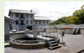
漁業集落排水施設
