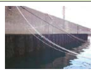
老朽化した岸壁の状況
