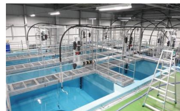
陸上養殖サーモンプラント © FRDジャパン
