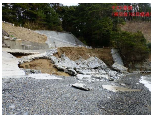
写真-3.1 時系列変化の把握（東日本大震災での被災箇所）
