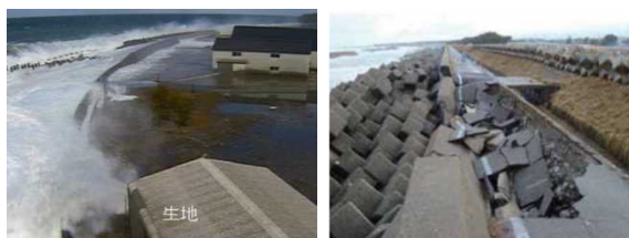
高波の越波状況（黒部市生地地区）
