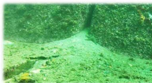
港湾構造物の前肢端部の状態
