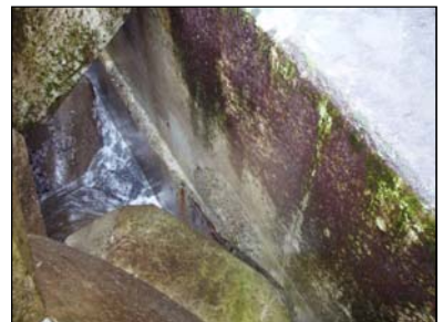
本體工の剥離、欠損
