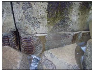
本體工の欠損、鉄筋の露出
