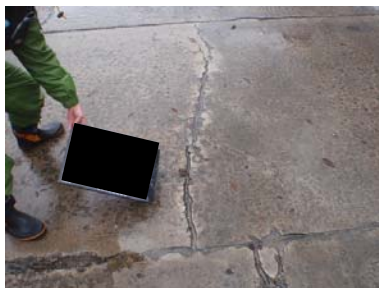
ひび割れ補修後再劣化
