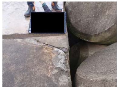
ひび割れ補修後再劣化
