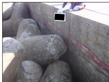
消波工の沈下
