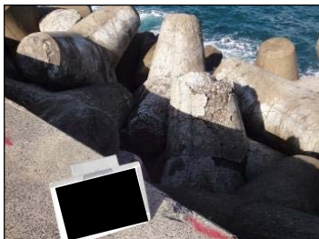
消波工の欠損、沈下
