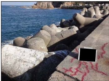
消波工の沈下
