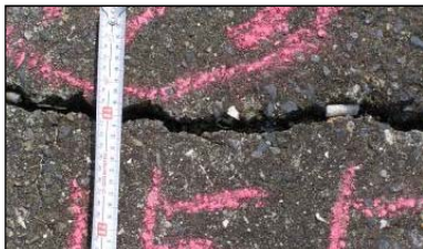
本體工のひび割れ
