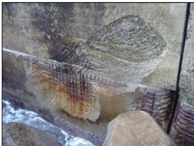
本體工の欠損、鉄筋の露出
