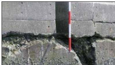
本體工の欠損
