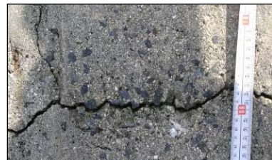
本體工のひび割れ
