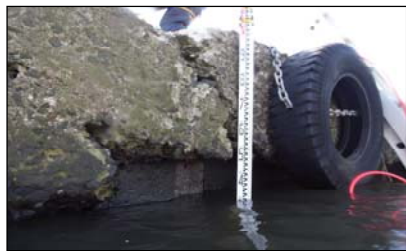
上部工の欠損・ひび割れ
