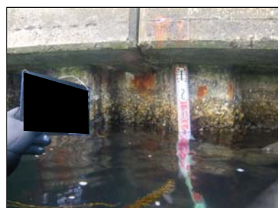
鋼矢板の発錆
