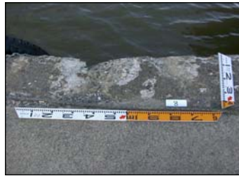
上部工の欠損
