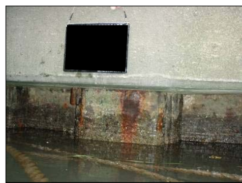
鋼矢板の発錆
