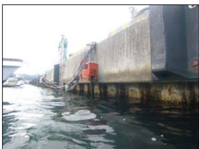
鋼矢板の発錆
