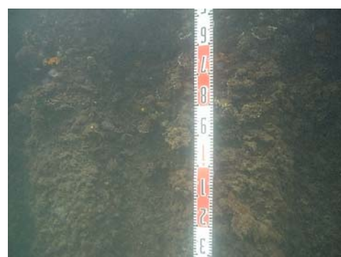
鋼矢板の発錆(水中)
