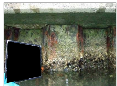
鋼矢板の発錆
