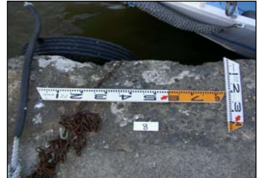
上部工の欠損
