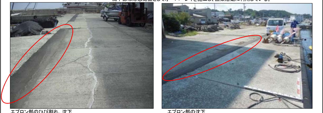
エプロン部のひび割れ、沈下 エプロン部の沈下
