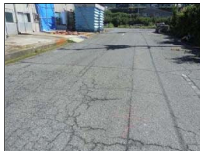
舗装のひび割れ
