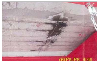
床版のひび割れ
