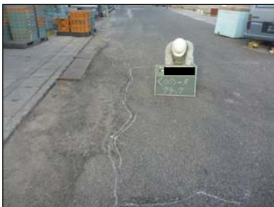
舗装のひび割れ
