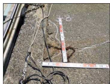
舗装のひび割れ
