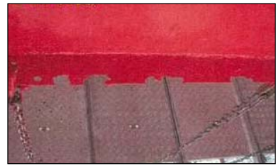
ブラケットの損傷
