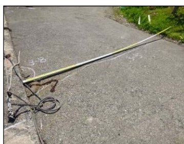
舗装のひび割れ
