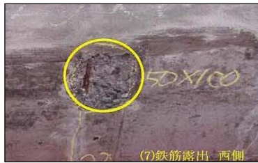
床版の鉄筋の露出
