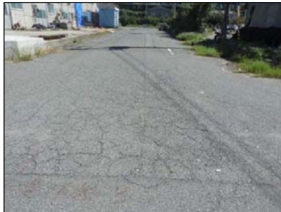
舗装のひび割れ
