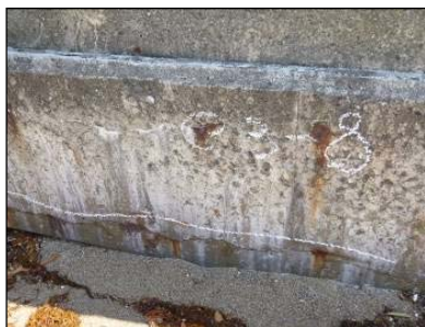
上部工のひび割れ
