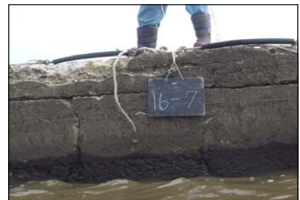
上部工の欠損
