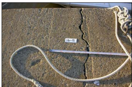
上部工のひび割れ
