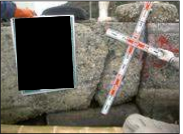
上部工のひび割れ、欠損
