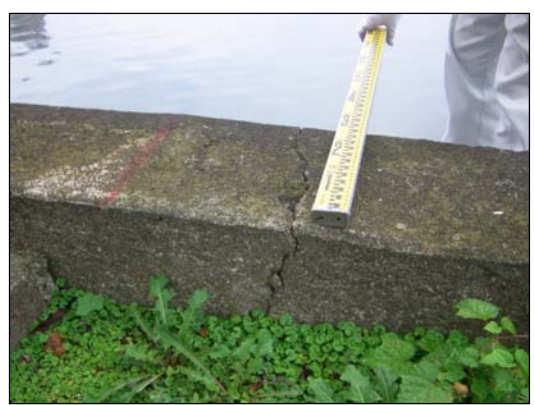
本体内のひび割れ
