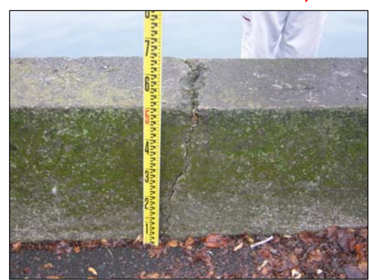
本体内のひび割れ
