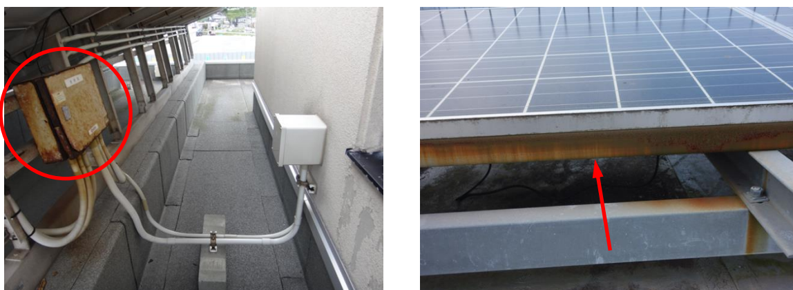
写真 3.1 漁港区域に導入された太陽光発電の塩害の事例 (左：接続箱の錆び、右：架台の錆び)
