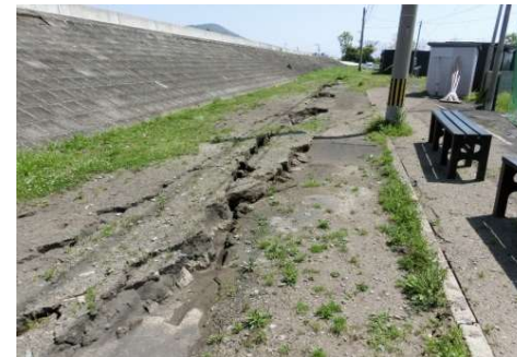
堤体の液状化
