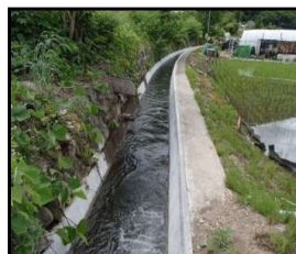
老朽化した用水路の整備・更新
