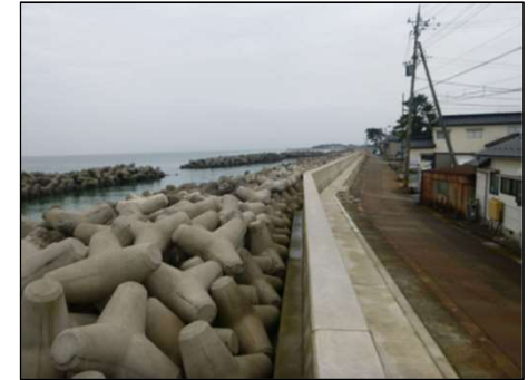
消波ブロックの設置や堤防高上げによる越波の防止
