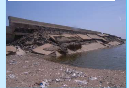
津波により洗掘された堤防
