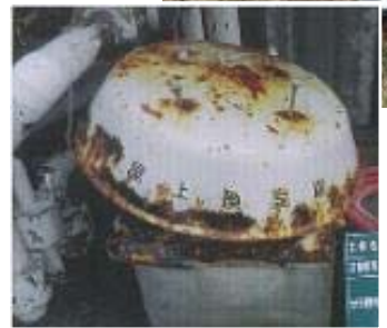
【換気施設の劣化状況】
