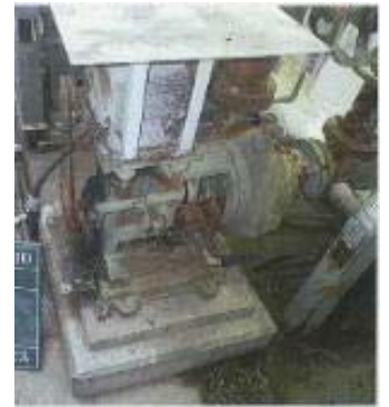
【陸上ポンプの劣化状況】
