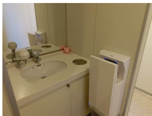
トイレの手洗い設備
