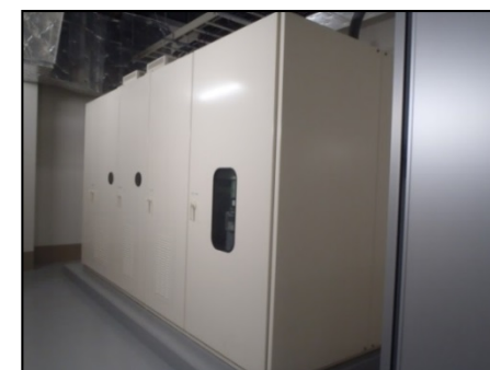
電源施設の浸水対策 (2階に設置)
