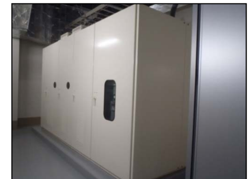
電源施設の浸水対策 (2階に設置)
