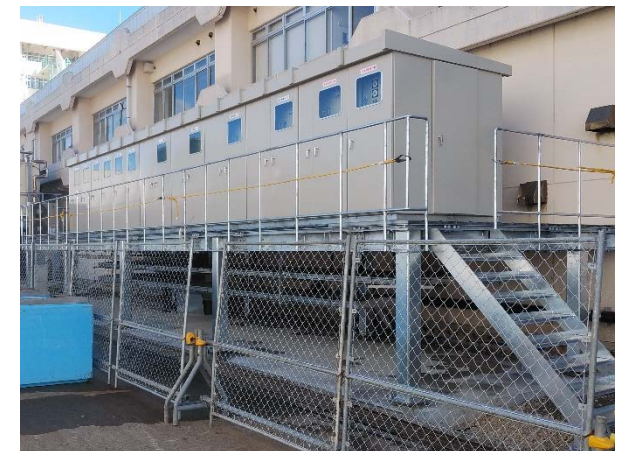
電源の高架化により浸水を防止
