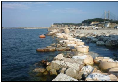
地震により岸壁が倒壊
