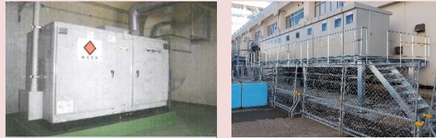
非常用電源の導入
