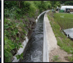
老朽化した用水路の整備・更新
