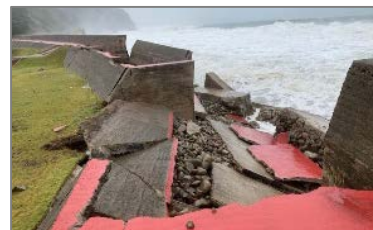
令和2年台風第10号による護岸の倒壊
