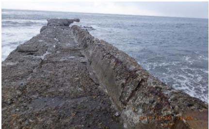
著しく老朽化した防波堤
