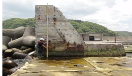
津波で流失した防波堤
